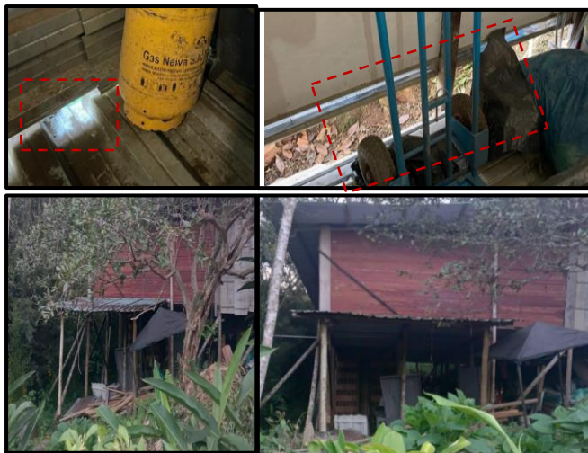
IMAGEN N°27 DETERIORO EN TALLER
