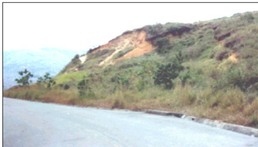
Lámina 20. Erosión por movimientos en masa
