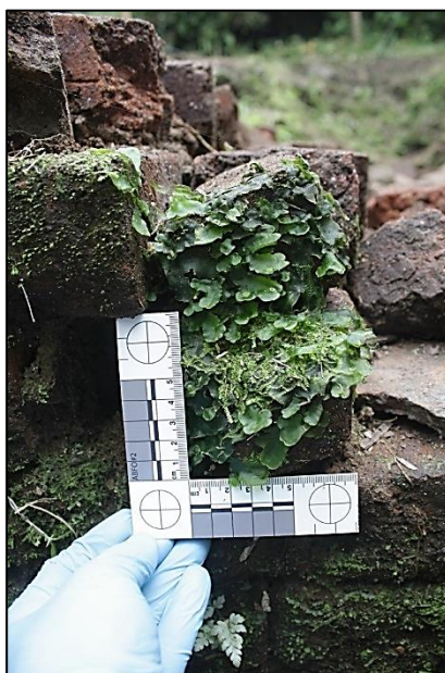
Ilustración 17. Presencia de musgo y líquenes sobre los ladrillos de los muros del sitio arqueológico.
