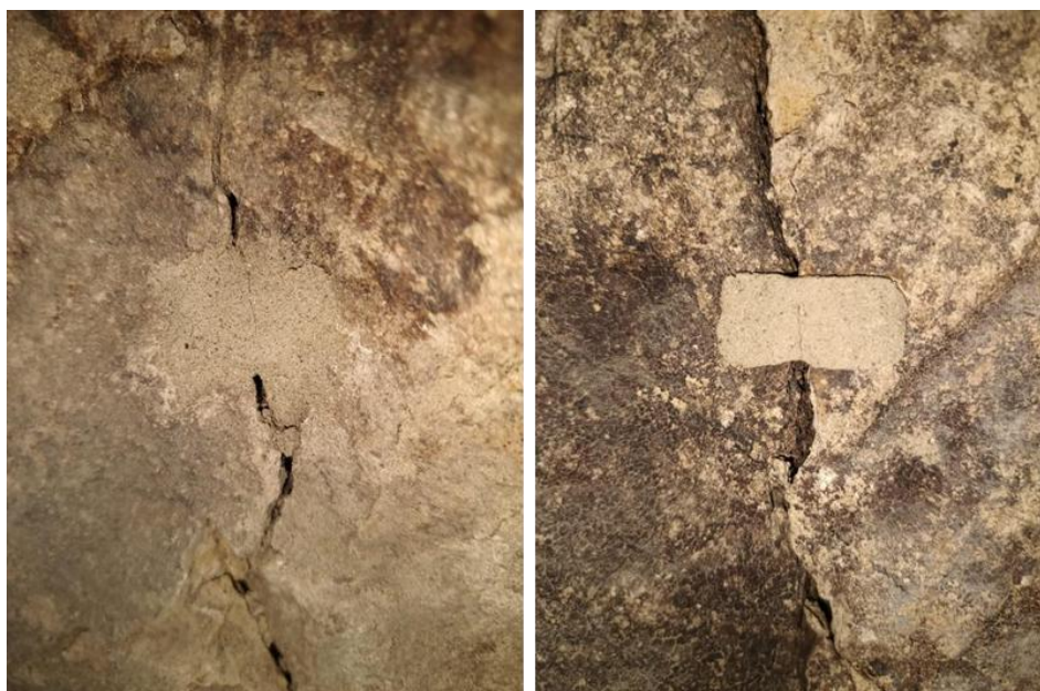
Ilustración 27. Testigos instalados en las diaclasas.
