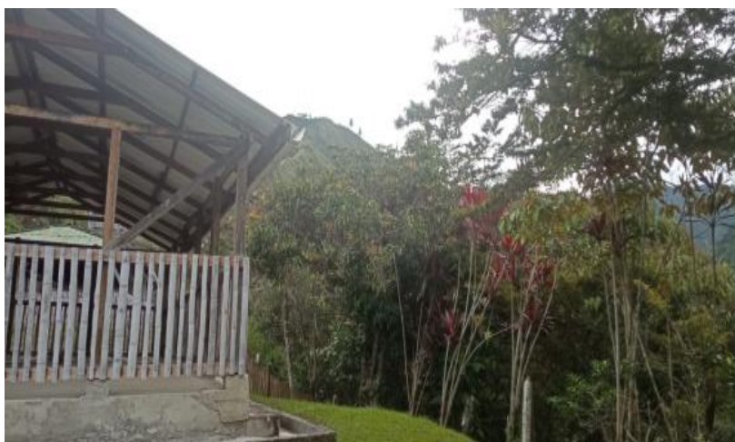
Ilustración 92.. Vista exterior del hipogeo SA1 donde se aprecia la proximidad de los árboles cuyas raíces afectan al interior.
