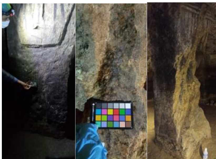
Ilustración 87. Zonas donde aún se evidencian los hongos y sobre las cuales se hicieron las pruebas de remoción directa Hipogeo S10
