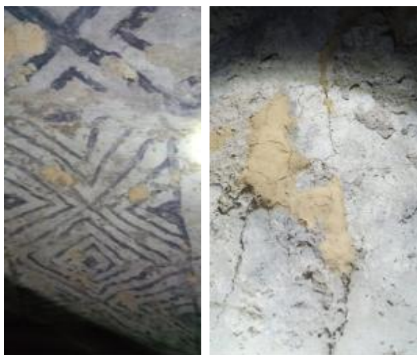
Ilustración 93. Zonas donde se recomienda evaluar la reintegración de los morteros de inyección o su reemplazo por estar agrietados. Hipogeo S12
