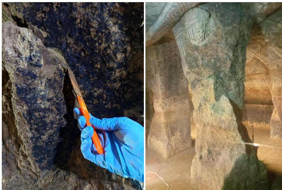
Ilustración 70. Izquierda aplicación de resane estructural y derecha, pilar 2 donde se aprecia en la parte alta, el fragmento adherido.
