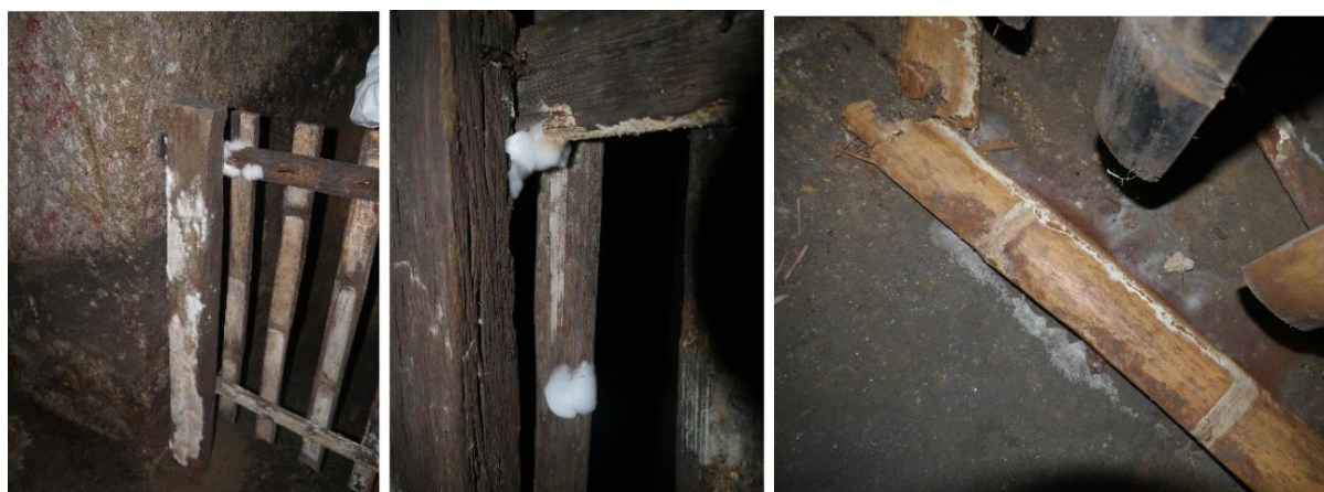
Ilustración 28. Cerca de madera deteriorada, la cual puede ser fuente de nutrientes para organismos y hongos xilófagos. Fotografías tomadas por Antonio Guarnizo-Pérez
