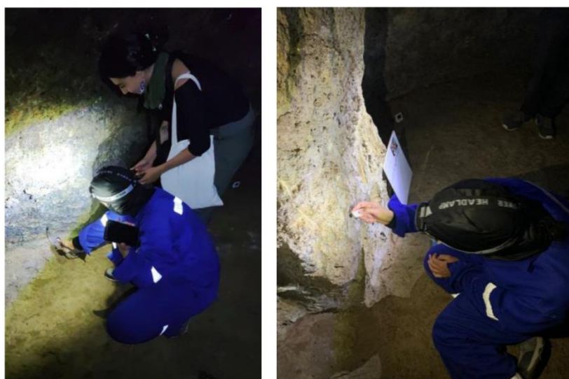
Ilustración 94. Mediciones de contenido de humedad realizados con el psicrómetro en cada lado de cada nicho y pilastra, hipogeos S11, S12. Fuente: Proyecto FIAN 2025-2026.
